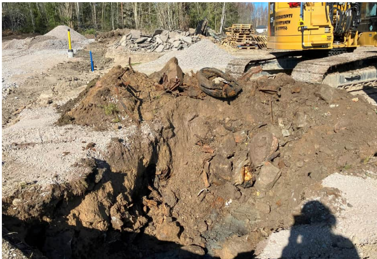
Kuva 7. Koekuopassa KK7 todettiin VNA:n 214/2007 mukaisen alemman ohjearvon ylittävä pitoisuus sinkkiä.
