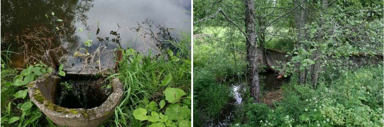
Kuva 44 a ja b. Vesirakenteet ovat elinkaarensa loppuvaiheessa.
