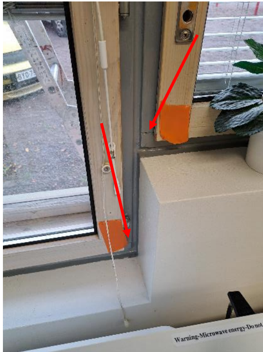
Kuva 1. Tilassa 130 havaittiin ilmavuotoa karmien liitosten rajapinnoilta.
