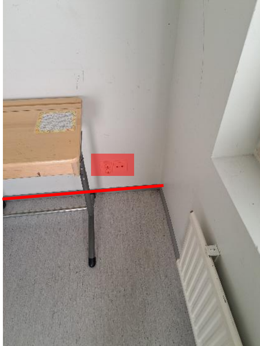
Kuva 3. Tilojen 101,102 ja 109 välisten väliseinien sisältä havaittiin ilmavuotoa rakenteiden rajapinnoilta ja sähkörsioiden kautta.
