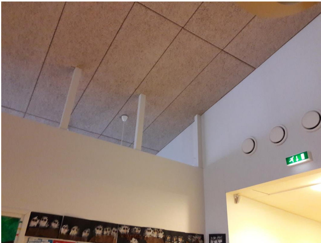
Myllymäen koulun laajennusosan aulatilasta on erotettu kevyillä väliseinillä tila, johon ei ole rakennettu ilmanvaihtoa.
