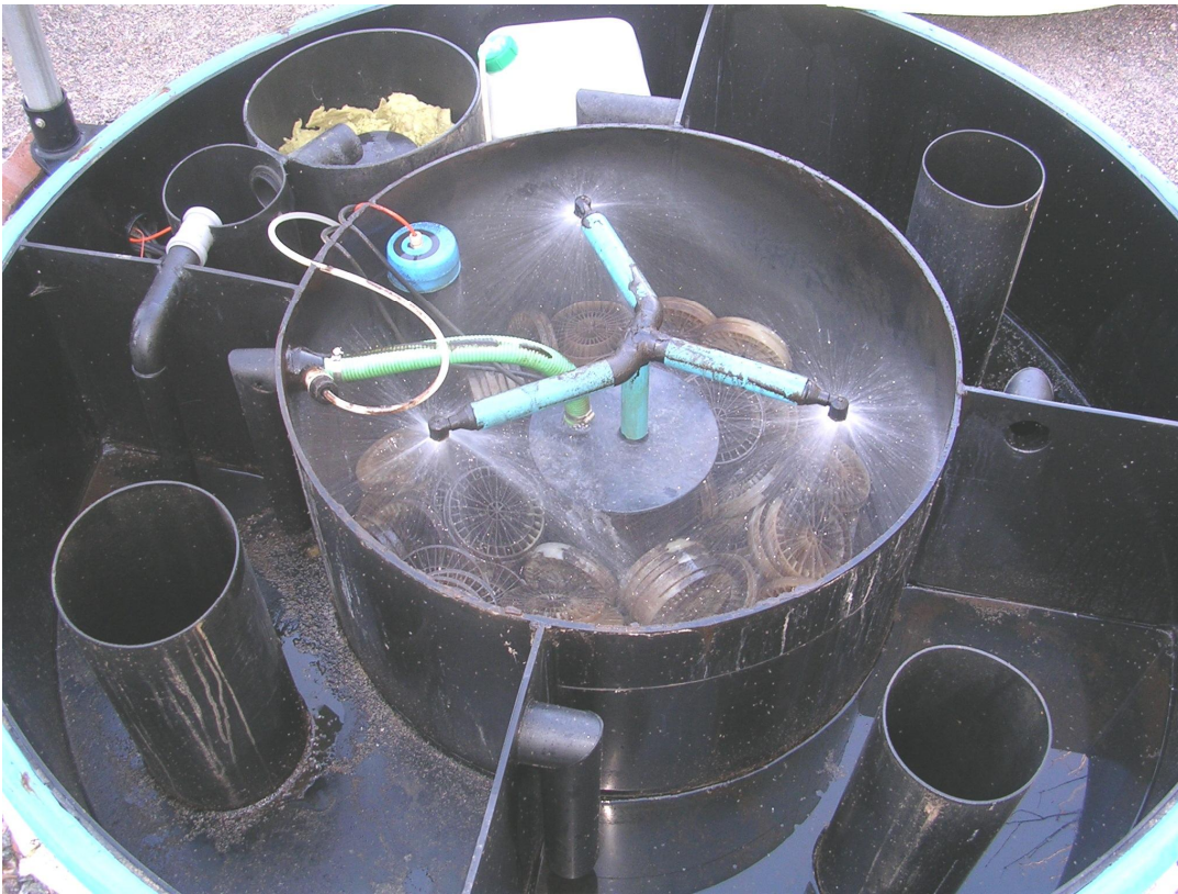
Kuva 2. Kiinteistö 5 (Green Pack Sako Plus 2). Keskellä on puhdistamon biosuodinos.
