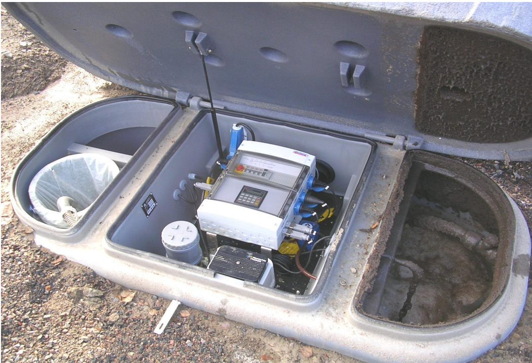
Kuva 3. Kiinteistö 7 (Wehoputs 5 panospuhdistamo). Vasemmalla lietepussi ylijäämälietteelle, keskellä ohjausyksikkö ja oikealla näkyy prosessiallas.
